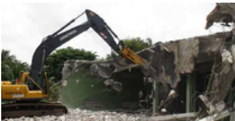
Demolición del edificio que alojaba el Material Bélico de la M. de G.
